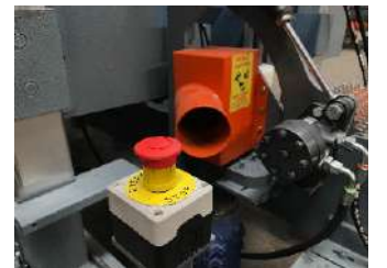
Emergency-stop buttons Acil-Stop butonları
